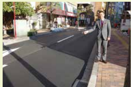
▲ひび割れと水溜りのひどかった舗装も、雨の日には滑りやすかった歩道もすっかりきれいになりました。
